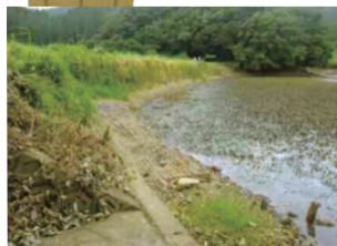
老朽化したため池
